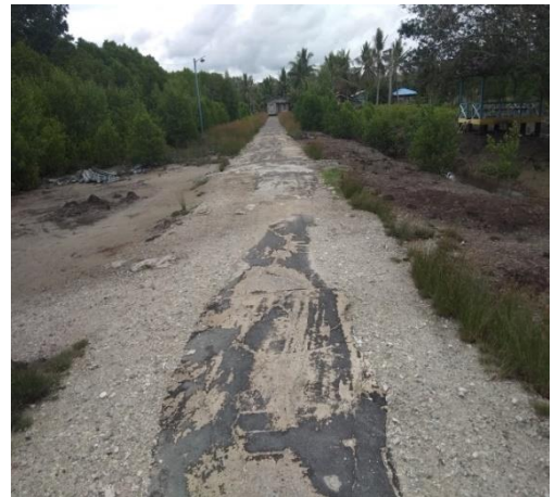
Gambar 5. Kondisi Infrastruktur Jalan di Kawasan Wisata Mangrove Desa Bokor
