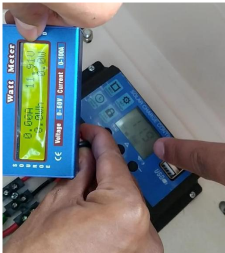
Gambar 6. Tampilan Solar Charge Controller pada Saat Menerima Energi dari Panas Matahari Berdasarkan Gambar 6, diketahui bahwa tampilan layar solar charge controller pada terdapat anak panah yang menunjukkan adanya aliran energi dari solar cell ke pest control lamp .
