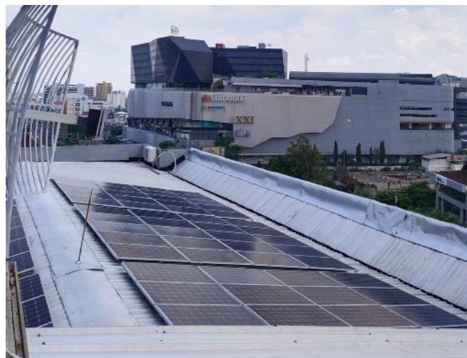
Gambar 4. Penggunaan Panel Surya di Gedung BAPPEDA Prov. Jawa Tengah
