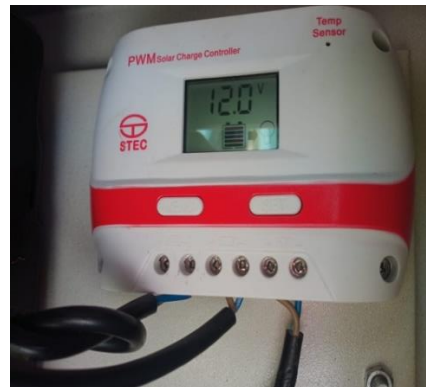
Gambar 12. Voltase Awal Baterai Untuk Penyalan Awal Lampu
