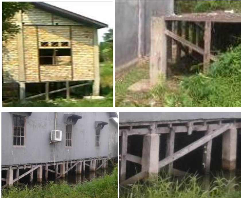
Gambar 6. Kombinasi Tiang Kayu dan Tiang Beton (sumber : Penulis, 2024)
