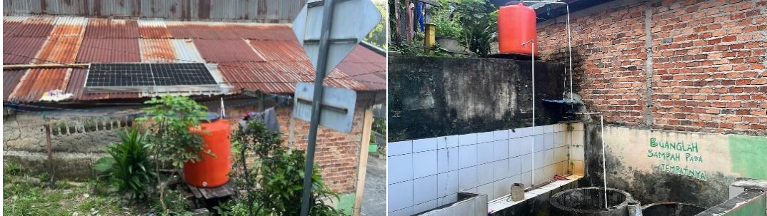
Gambar 4. Hasil Sistem Pompa Air Berbasis Panel Surya
