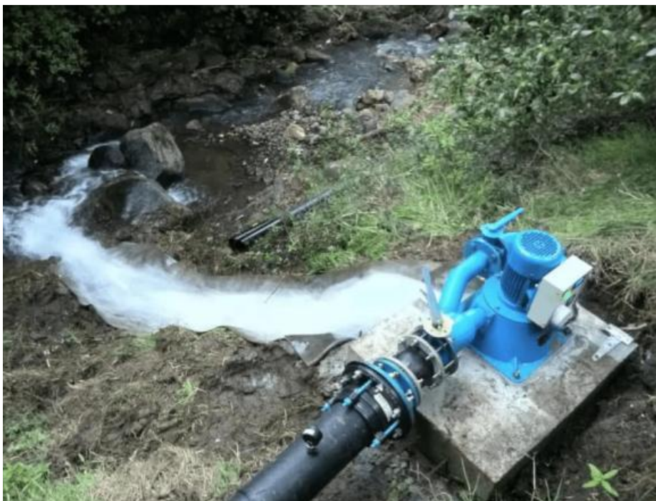
Gambar 4. Instalasi Sistem Pembangkit Listrik Tenaga Mikrohidro
