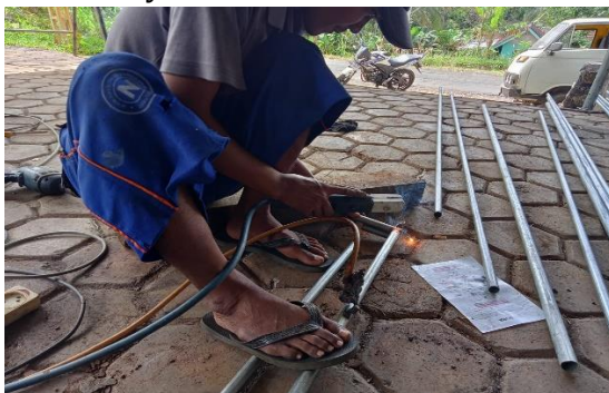
Gambar 3. Dokumentasi karyawan tidak menggunakan APD
