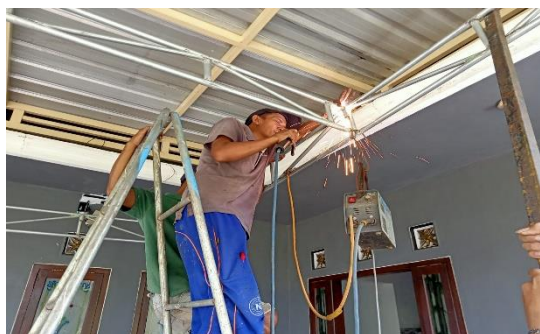
Gambar 2. Dokumentasi gambar Karyawan Bekerja Tidak Sesuai Prosedur K3
