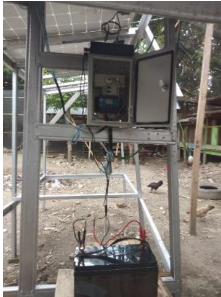
Gambar 10. Box kontrol dan Baterai
