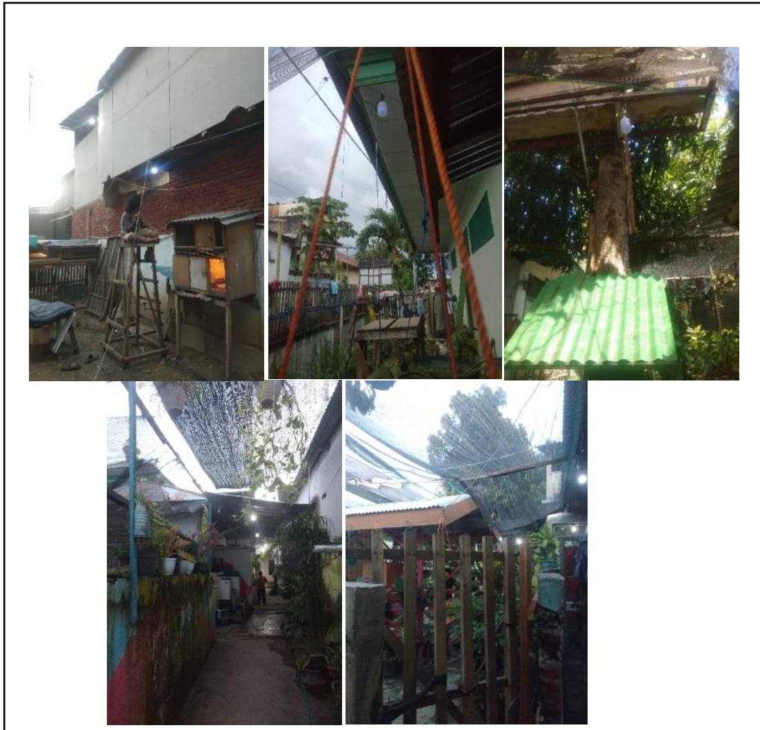
Gambar 9. Instalasi Lampu Penerangan Tenaga Surya
