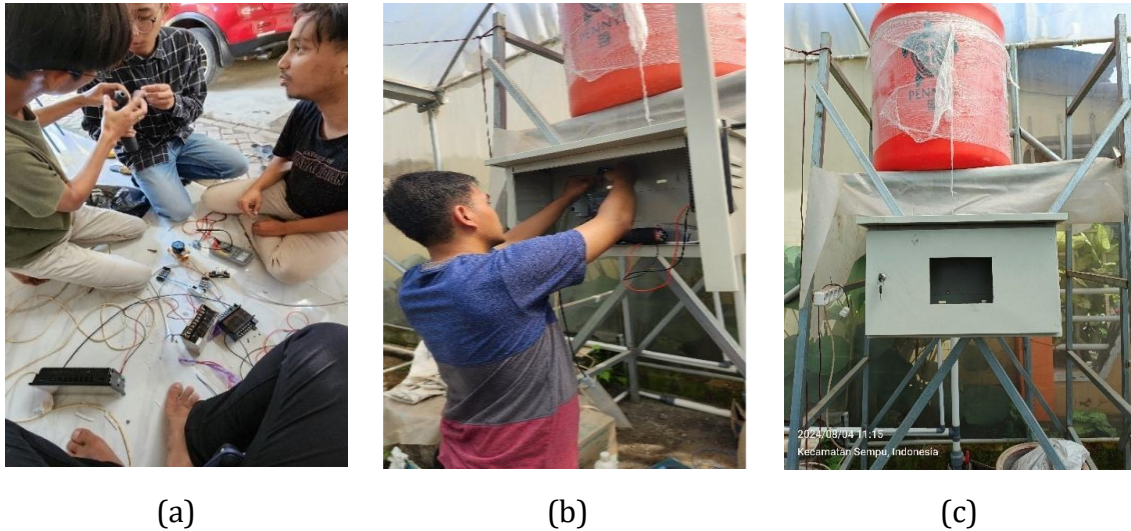
Gambar 5. Proses perangkaian alat dan kelistrikan yang terdiri dari (a) Rangkaian Listrik dan komponen elektronik modul kontroler (b) Pemasangan modul kontroler irigasi pada greenhouse (c) Lokasi tempat kontroler yang berisikan PLC dan HMI.
