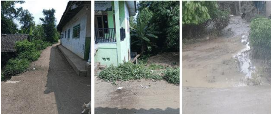
Gambar 2. Akses jalan menuju TPQ belum ada infrastruktur
