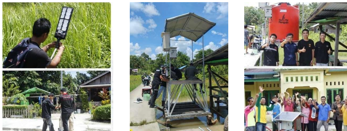
Gambar 6. Instalasi PJU TS dan filter air berbasis panel surya
