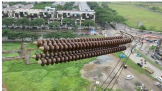
Gambar 2. Isolator 500 kV pada SUTET Balaraja – Lengkong T.185
